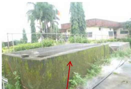
Photo 7 : Bacs en béton de 5m 3 en circuit ouvert situés à l'extérieur de l'éclosérie
